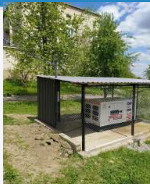
Встановлення генератора – 25 кВт
