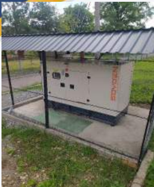
Встановлення генератора – 88 кВт
