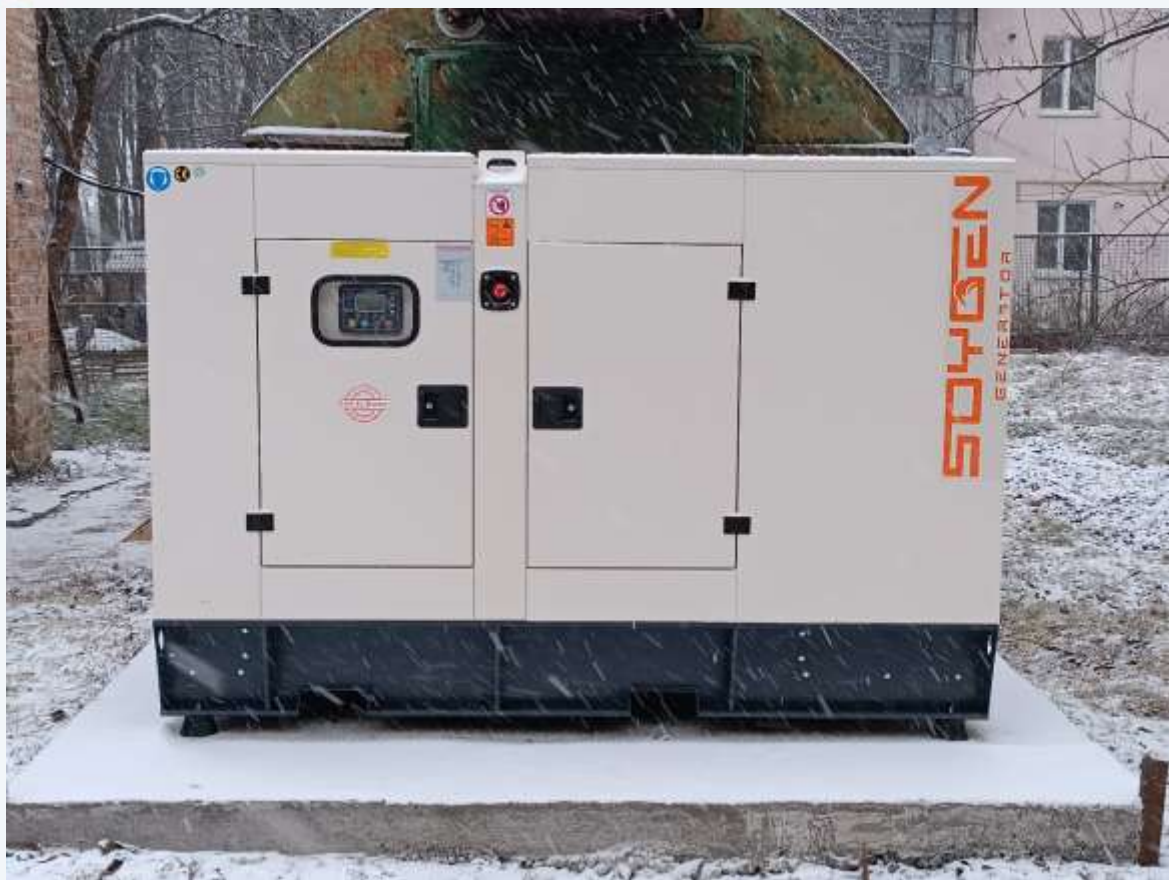
Генератор на 70кВт
