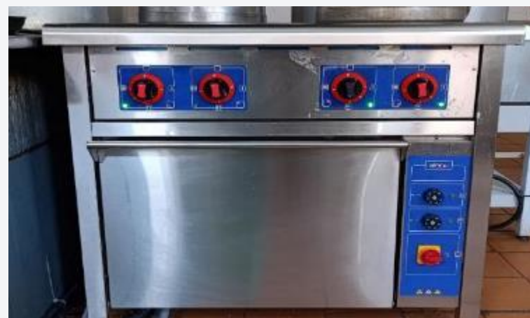
Придбано та встановлено 2 промислові електричні плити на харчоблоці
